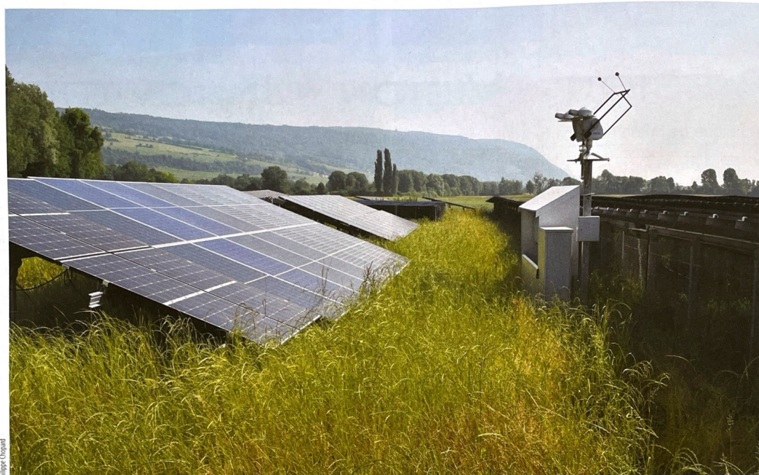
Cette petite station expérimentale créée à côté de la raffinerie de Cressier (NE) permet aux experts du Csem de tester plusieurs types de panneaux.
